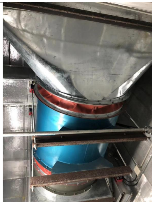
地下停车场排风系统
